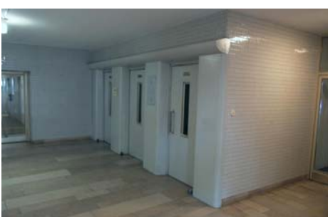
9006 Stadthaus I – Aufzugsanlage
