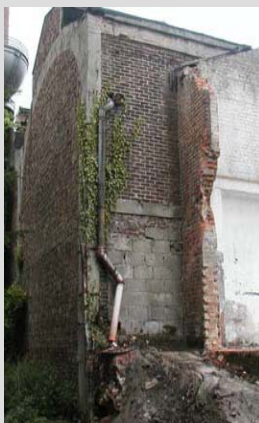
Alte marode Fassade u. unbebautes Gelände
